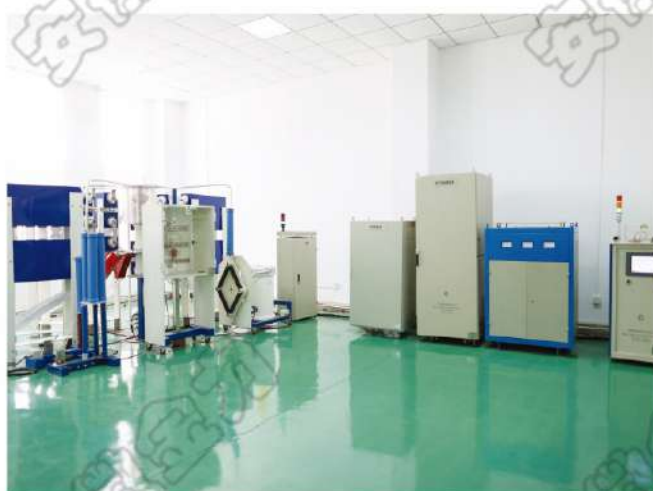
图九 电涌保护器试验大厅
